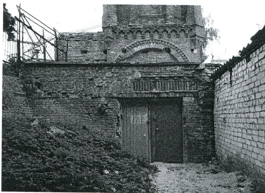
4. «Водонапорная башня. 1874 г.», г. Курск, ул. Павлова Элемент фасада. Материалы фотофиксации подготовил главный специалист ОБУК «Инспекция по охране объектов культурного наследия» Большакова Ю.А. Октябрь 2015 г.
